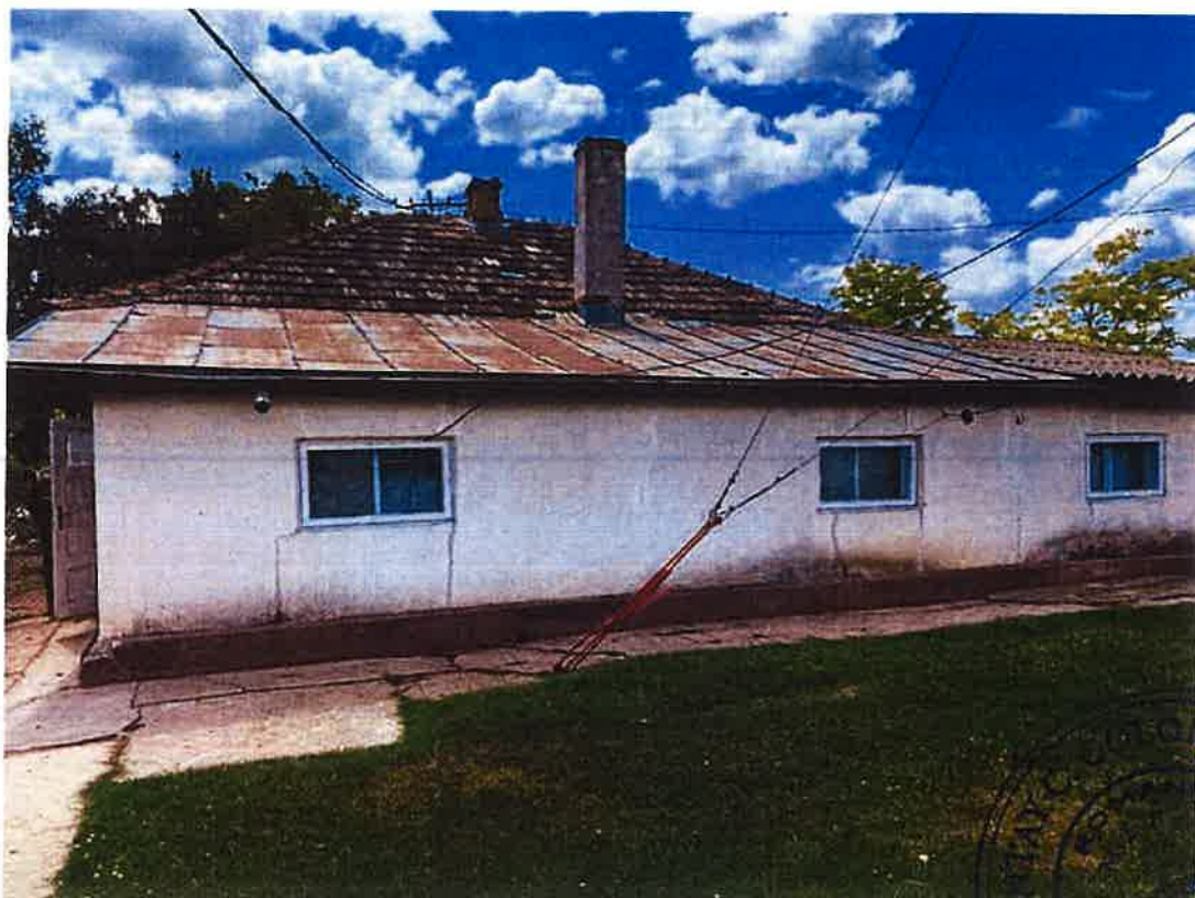
Foto 13.2 Fisuri verticale și infiltrații apă
