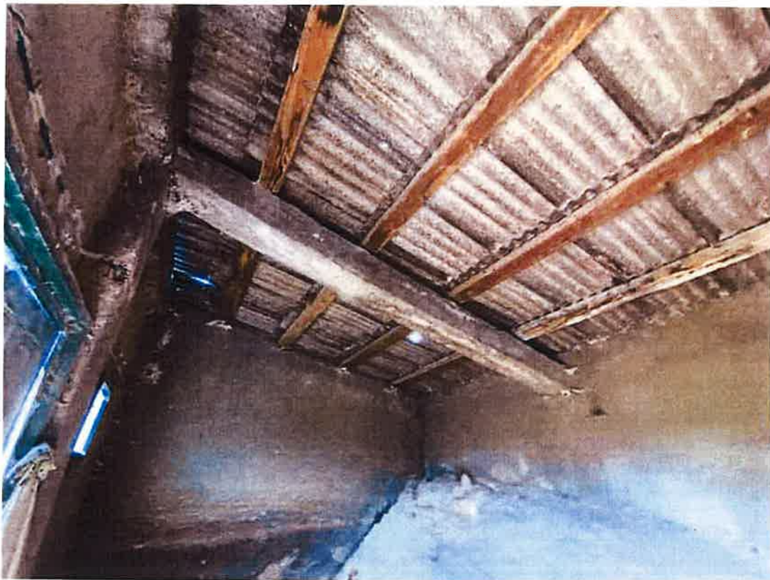
Foto 13.1 Elemente structurale sub-dimensionate acoperiș corp C2 anexă
