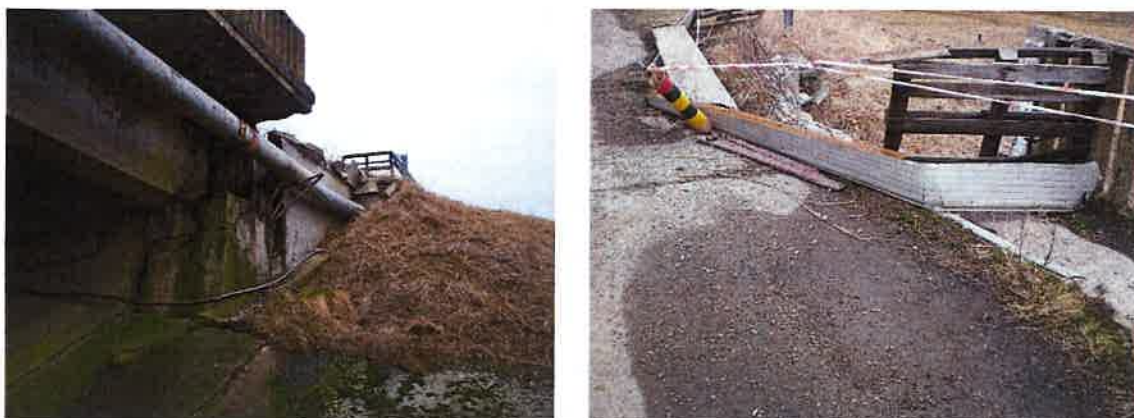
Foto nr. 12 – Culeea mal stang avariata – pod rutier peste DAM
