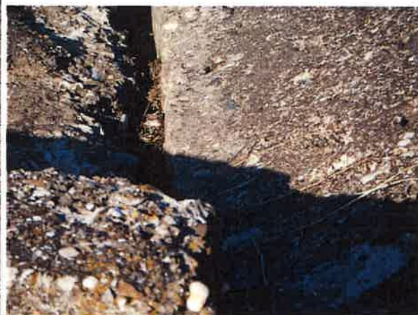
D.A.M – canal rapid degradat
