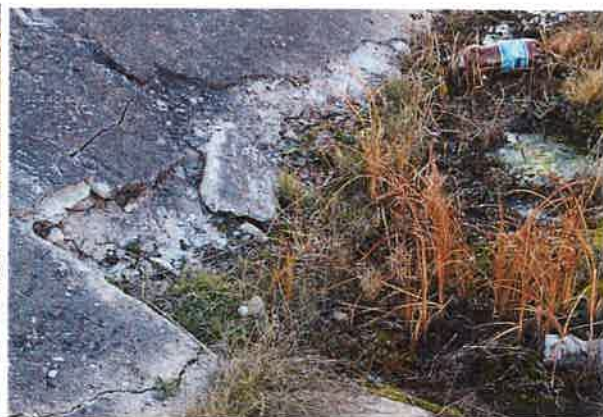
D.A.M.- canal rapid degradat
