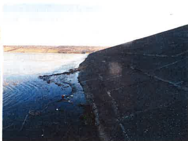
Taluz amonte- pereu subspălat
