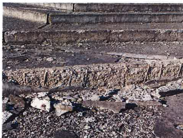
D.A.M.- canal rapid degradat
