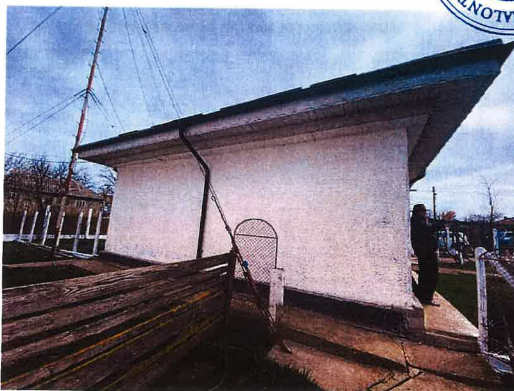
Foto 13.2 Ușoare infiltrații apă la nivelul pereților
