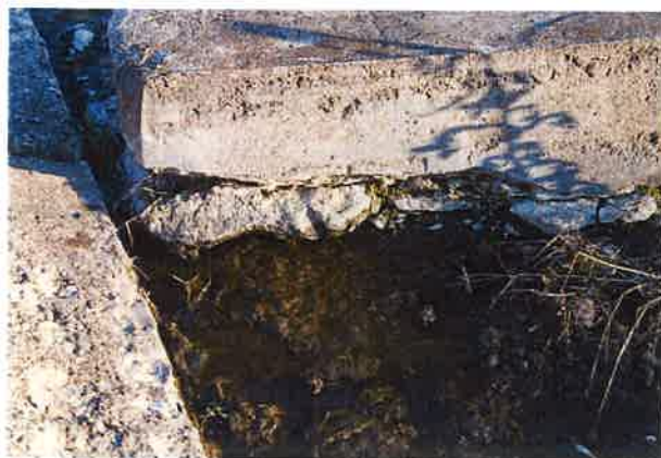
D.A.M.- canal rapid degradat
