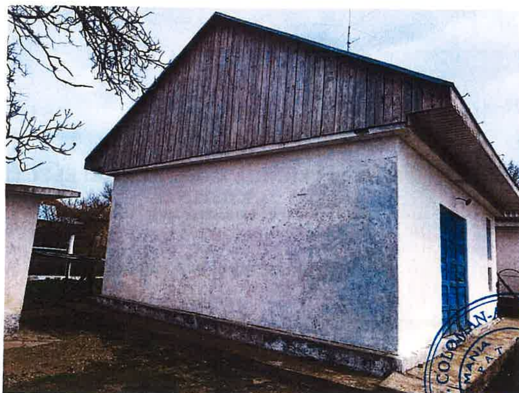
Foto 13.1 Tencuieli desprinse corp anexă
