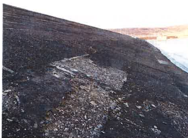
Taluz amonte- pereu degradat
