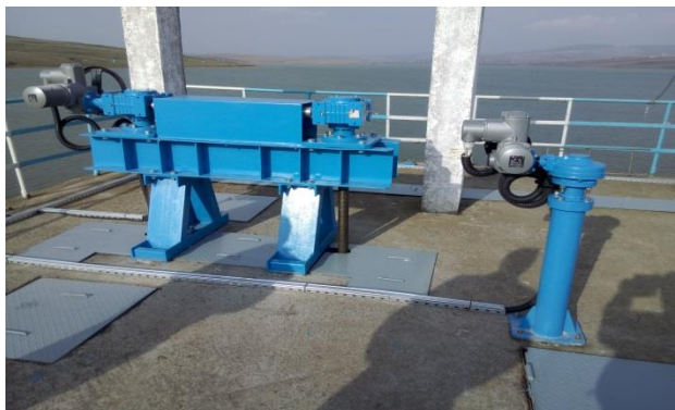
Foto 3 – Creșterea gradului de siguranță a acumulării Tungei, pe râul Sacovăț, județul Iași – Turnul de manevră - Echipamente de acționare a stăvililor
