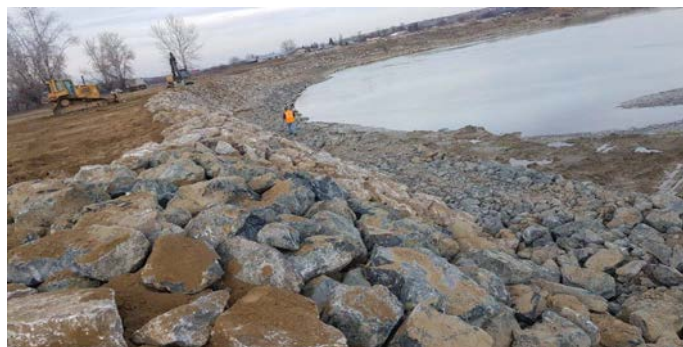
Foto 5 – Amenajare râu Siret în localitatea Șerbești Vechi, jud Galați - Consolidare de mal prism de anrocamente
