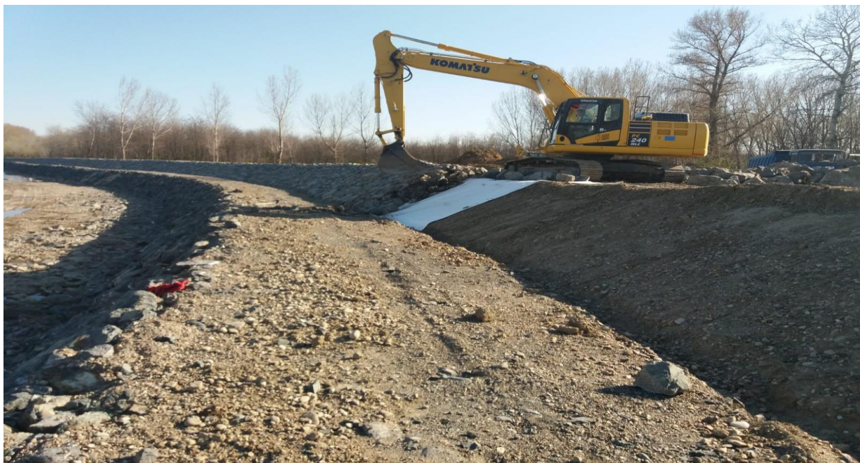
Foto 1 – Amenajarea raului Siret pe sectorul Homocea- conflueanta cu fluviul Dunarea, jud Galati Pereu de anrocamente
