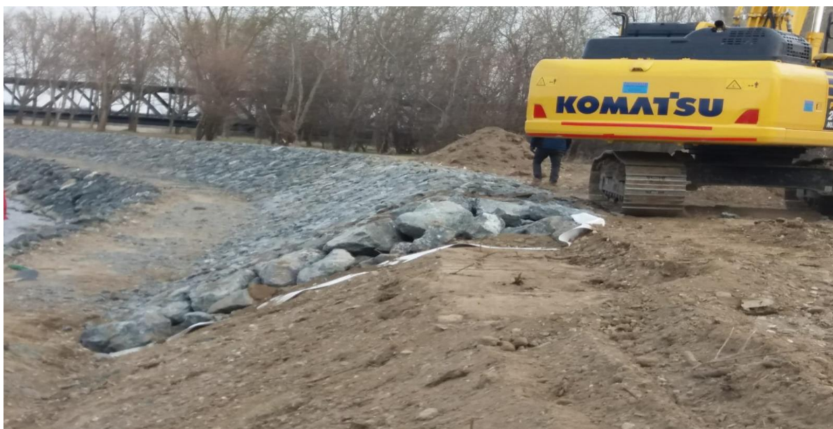
Foto 3 – Amenajarea raului Siret pe sectorul Homocea- conflueanta cu fluviul Dunarea, jud Galati Prelu de anrocamente
