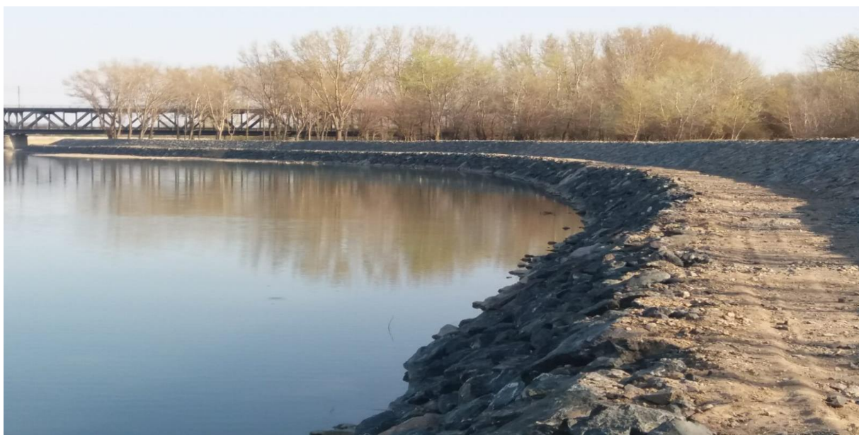
Foto 2 – Amenajarea raului Siret pe sectorul Homocea- conflueanta cu fluviul Dunarea, jud Galati Prism si pereu de anrocamente
